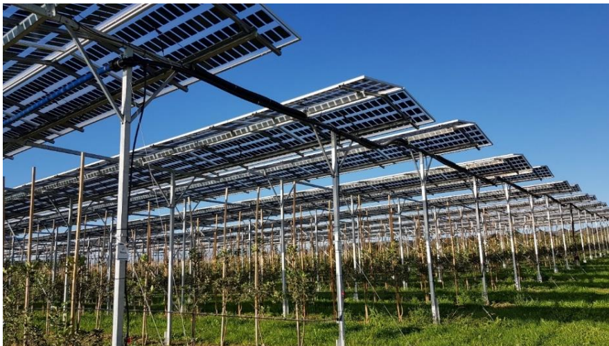
Foto: Agri-PV-Anlage am KOB in Bavendorf
